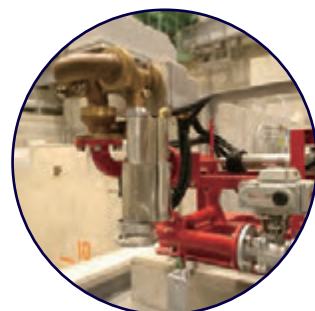
ごみピット放水銃
